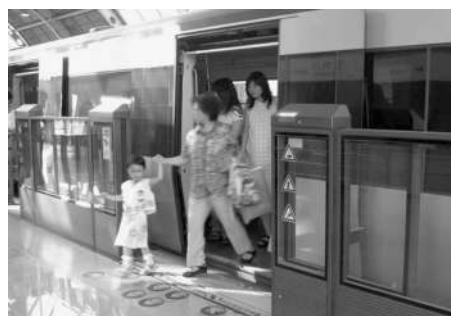
写真12 天津地下鉄の可動式ホーム柵
